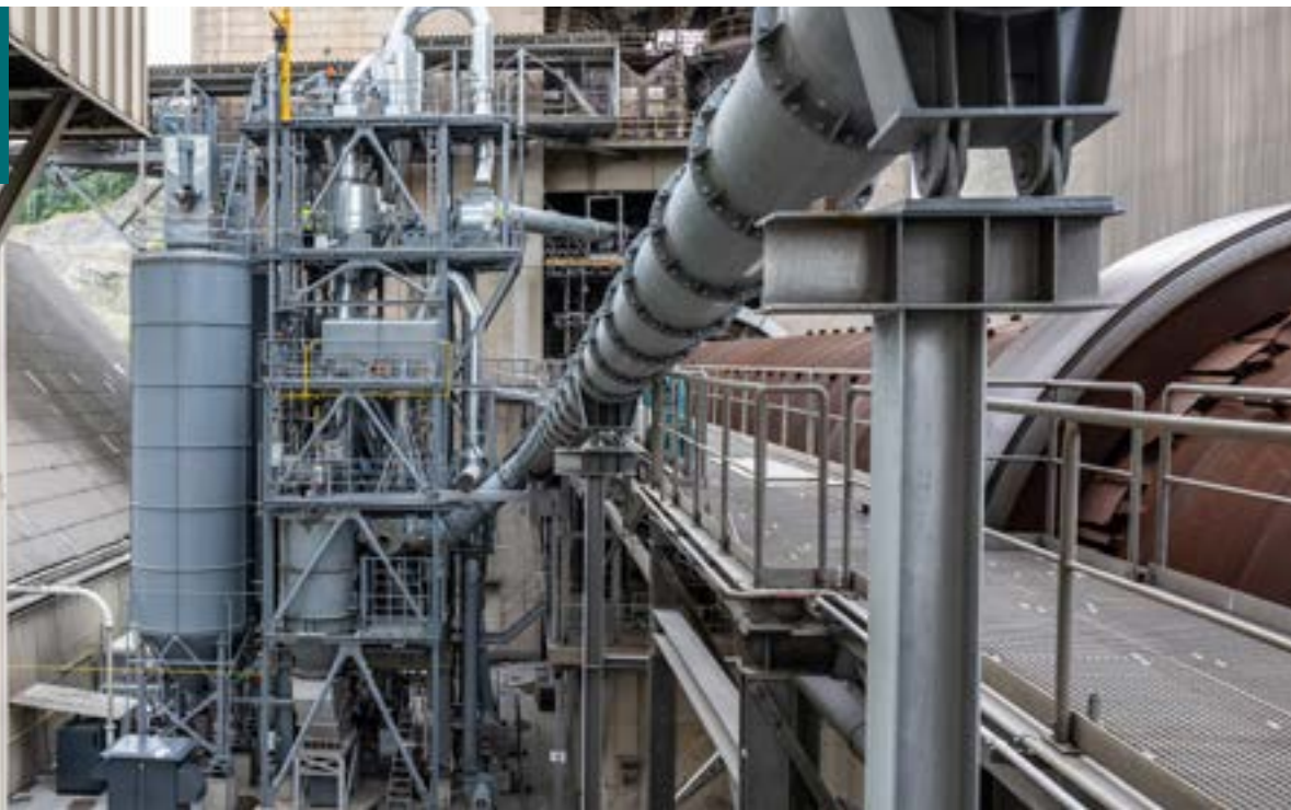
Versuchsanlage für getemperte Tone im Zementwerk Rohrdorf
